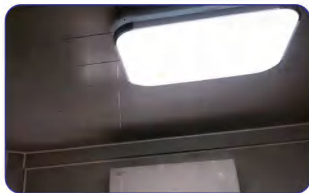
存在严重的漏水隐患
