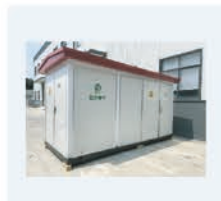
装配式高、低压预装式变电站
